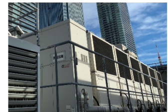
屋上の省エネ設備
