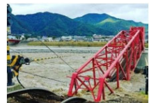
橋脚が落下した上田市別所線
